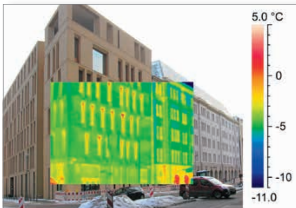
Thermografie der Straßenfassade von Alt- und Neubau des BMU in Berlin zur Überprüfung der Ausführungsqualität
